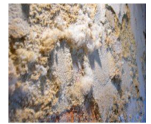
mur recouvert de salpêtre
